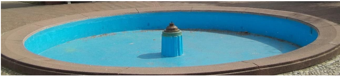
Fotografía 6.10: Estado actual de la fuente de La Rosaleda.
