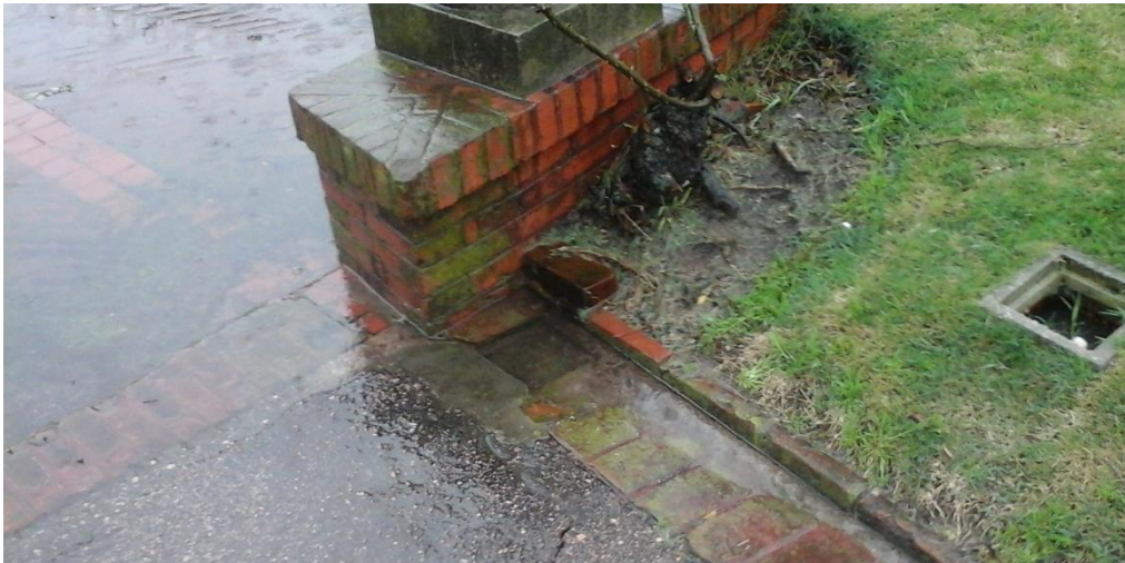
Fotografía 6.16: Bocas de desagüe tapadas.
