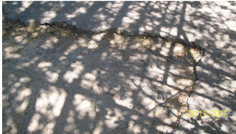
Fotografía 6.9: Pavimento asfáltico afectado.
