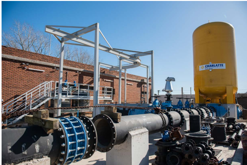
Estación de Bombeo Manga, año 2022.
