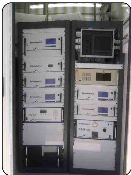
Ilustración 1.4 Estación Automática de Gases
