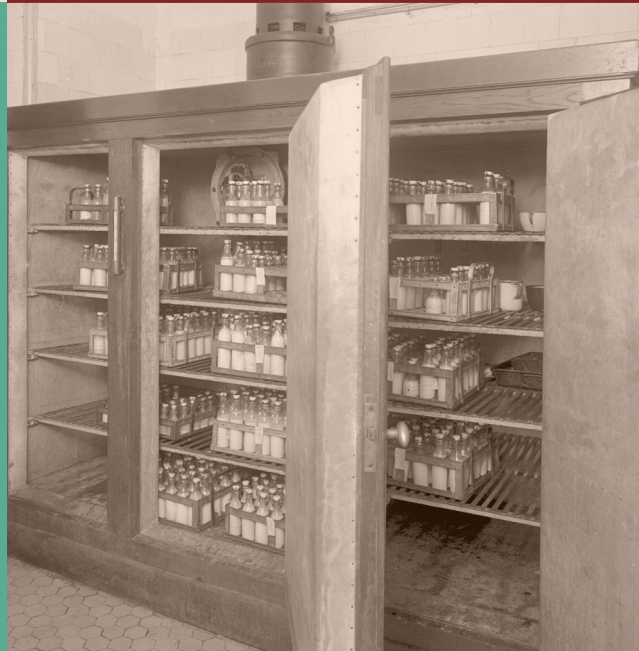
▶ Cámaras frigoríficas para maderas Hospital P. Visca
