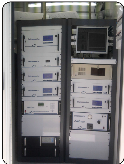
Ilustración 1.4 Estación automática de gases
