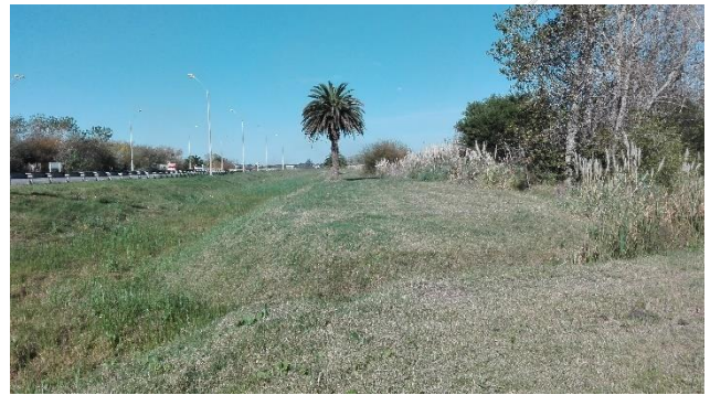
Llegada de la cuneta Melilla Este a la cuneta paralela a ruta N°102 lado sur
