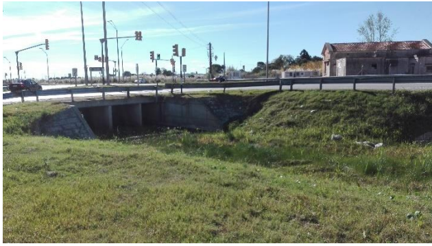
Alcantarilla por debajo de Cno. Melilla
