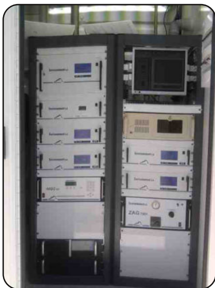
Ilustración 1.4 Estación automática de gases
