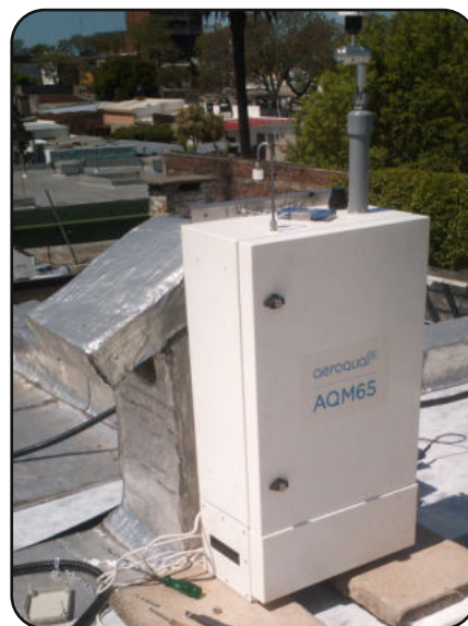
Ilustración 1.5 Estación material particulado y gases
