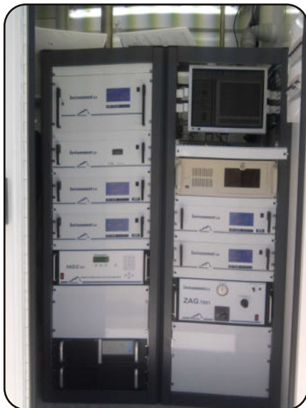
Ilustración 1.4 Estación automática de gases
